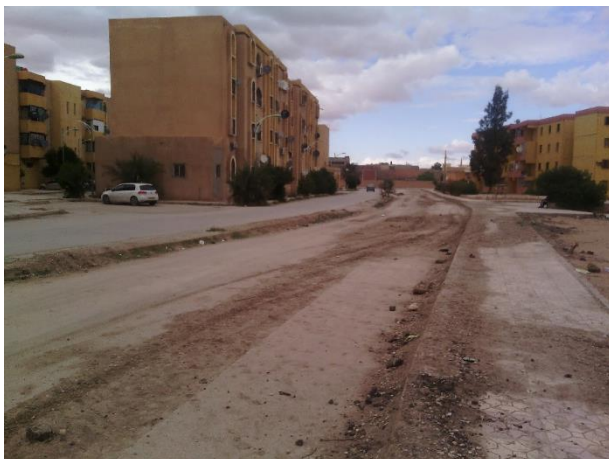
Photo 34 : Dégradation des voies
