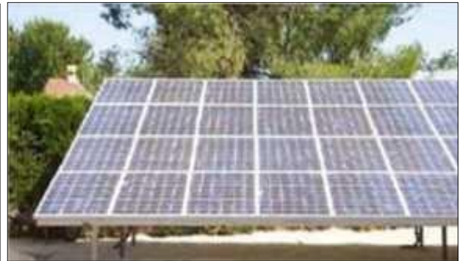
Figure 9 : Des photovoltaïques au sol
