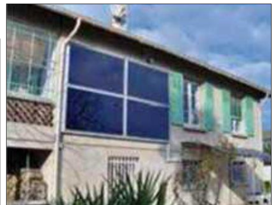
Figure 11 : Des photovoltaïques en façade
