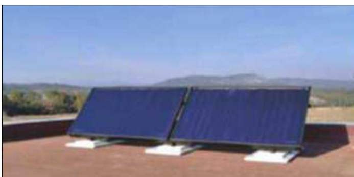
Figure 12 : Des photovoltaïques en toiture terrasse
