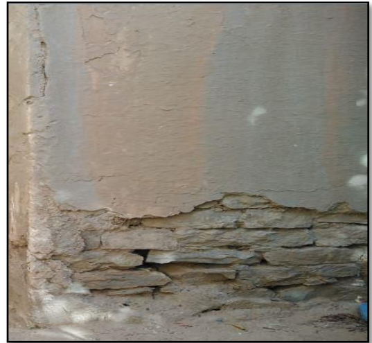
الشكل(97): تآكل الأساسات المصدر: الطالب
