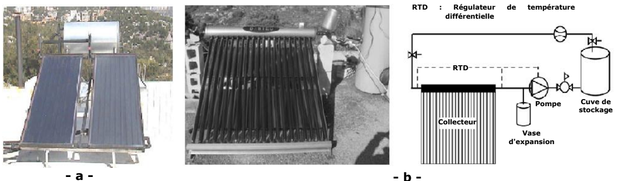
Figure I.7 : Types de capteurs solaires : (a) Capteur plan (b) Banc d'essai expérimental et son schéma synoptique.
