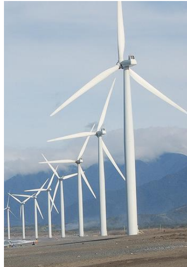
Fig. 1.16 : Aérogénérateur de 100 kW.
