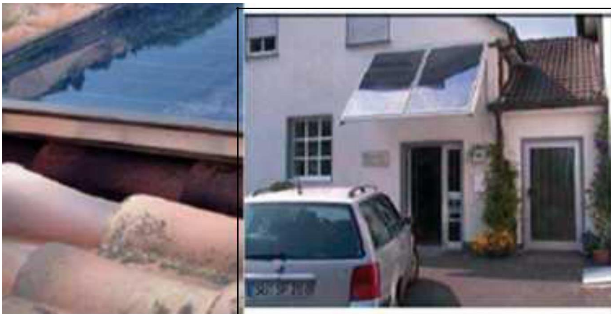
Figure 5 L'installation des panneaux photovoltaïques en auvent d'une ou brise soleil
