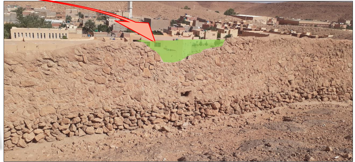
صورة 58 توضح الجزء المنهار من السور المصدر: الباحث 2022-06-18
