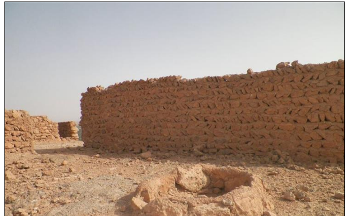
صورة 41 أجزاء من المساكن منهارة في القصر المصدر : الباحث بتاريخ 2022-02-19
