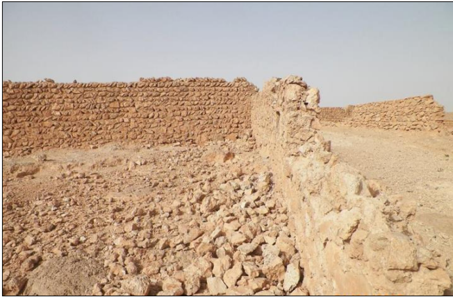
صورة 42 أجزاء من المساكن منهارة في القصر المصدر : الباحث بتاريخ 2022-02-19
