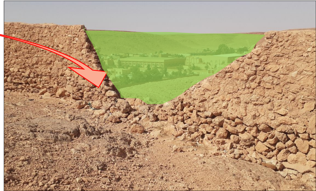
صورة 59 توضح الجزء المنهار من السور المصدر: الباحث 2022-06-18
