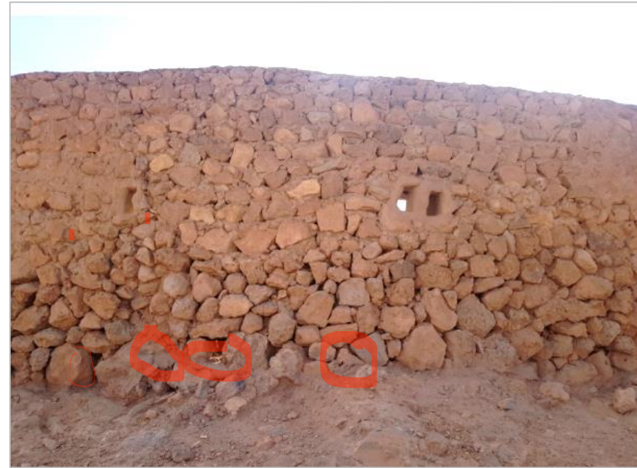
صورة 54 توضح حالة قواعد السور ومجري تصريف مياه الامطار المصدر : الباحث 2022-06-18
