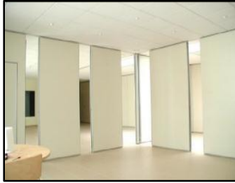
Figure 4 : Les parois mobiles. Source : http://linconyl.com/16-interieur
