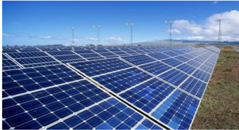
Figure.I. 5: Les panneaux photovoltaïques fixes
