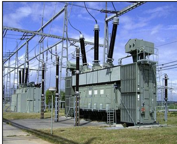
Fig.1.5 Transformateur de puissance dans un poste électrique [5]
