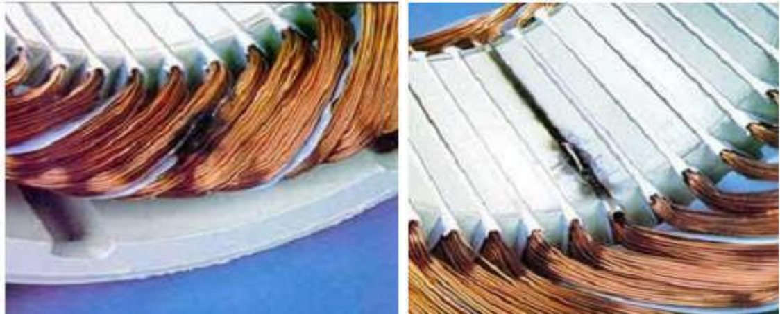
Au niveau des têtes de bobines
