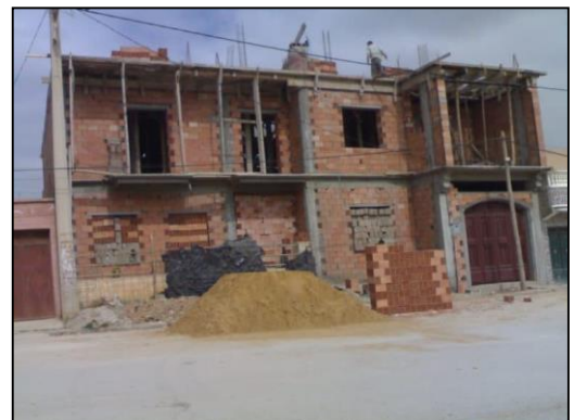
FigI.35 : une auto-construction (source : www.algerie-focus.com )
