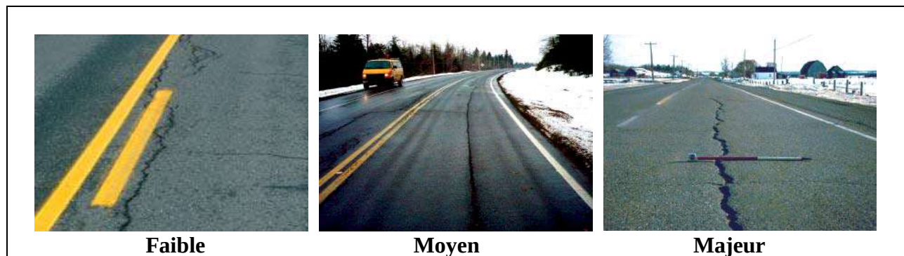
Figure I.20 : Fissures longitudinales hors-piste de roues (d'après AIMQ 2002)
