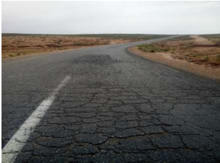
Figure III.2 : Une section dégradée de la RN 23 au PK 356+400
