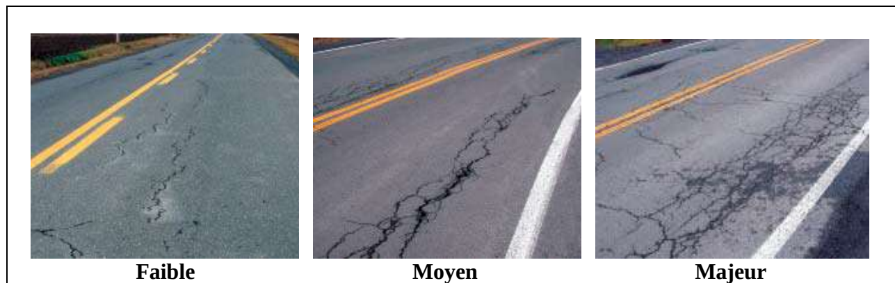
Figure I.19 : Fissures longitudinales en piste de roues (d'après AIMQ 2002)
