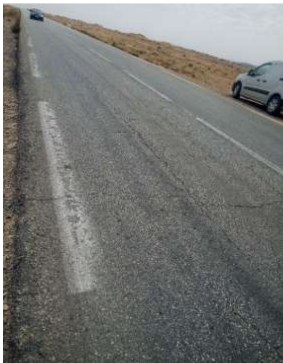
Figure III.3 Fissures transversales et longitudinales au PK 361+100
