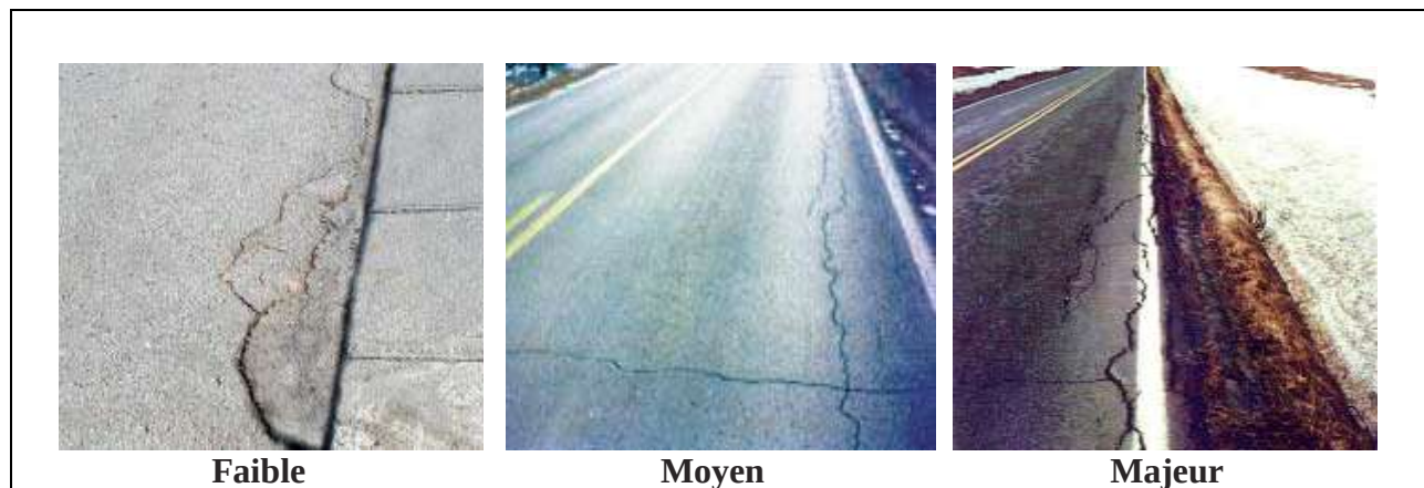
Figure I.23 : Fissures en rive (d'après AIMQ 2002)
