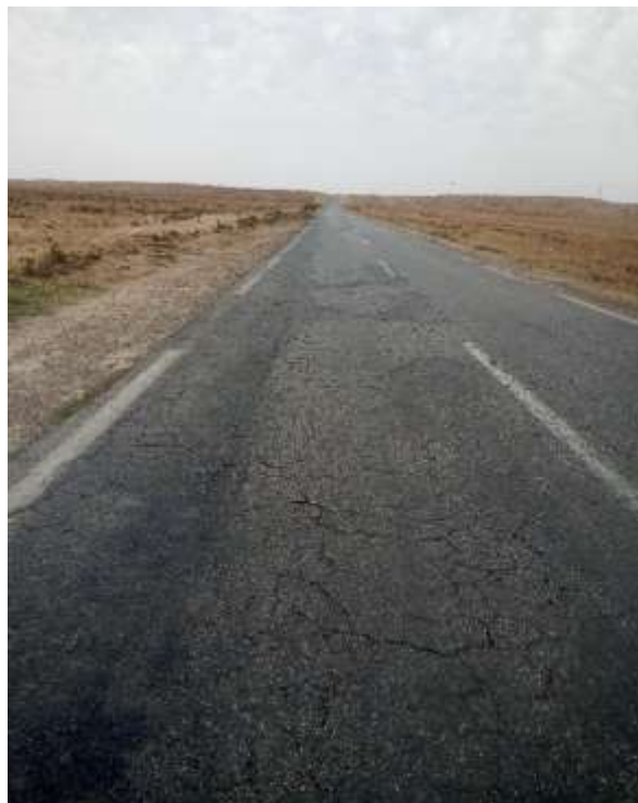
Figure III.4 Faïençages à mailles fines au PK 364+400
