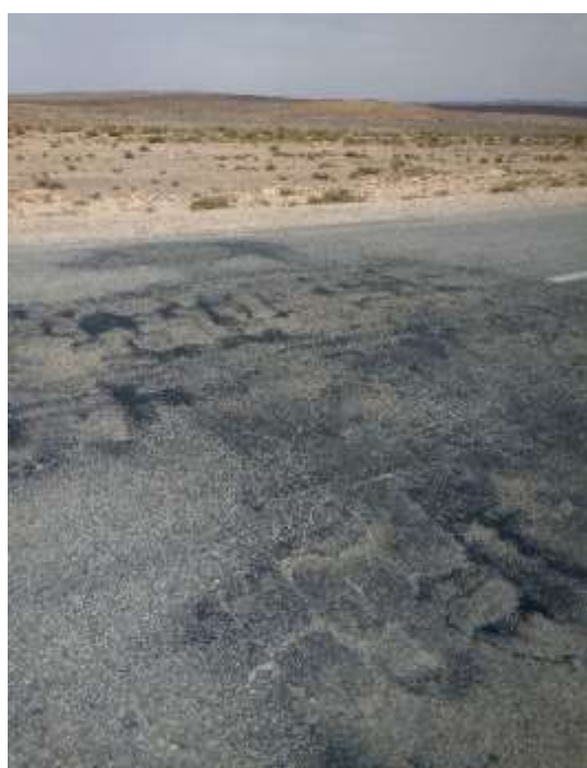
Figure III.6 Section déformée avec Faïençages à mailles fines au PK 366+400
