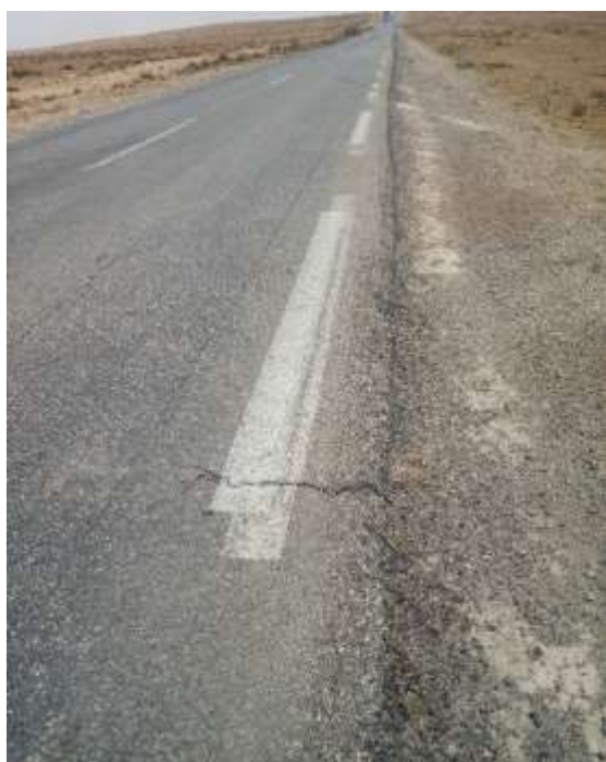
Figure III.5 Fissures au bord de la chaussée et fissures transversales au PK 358+200
