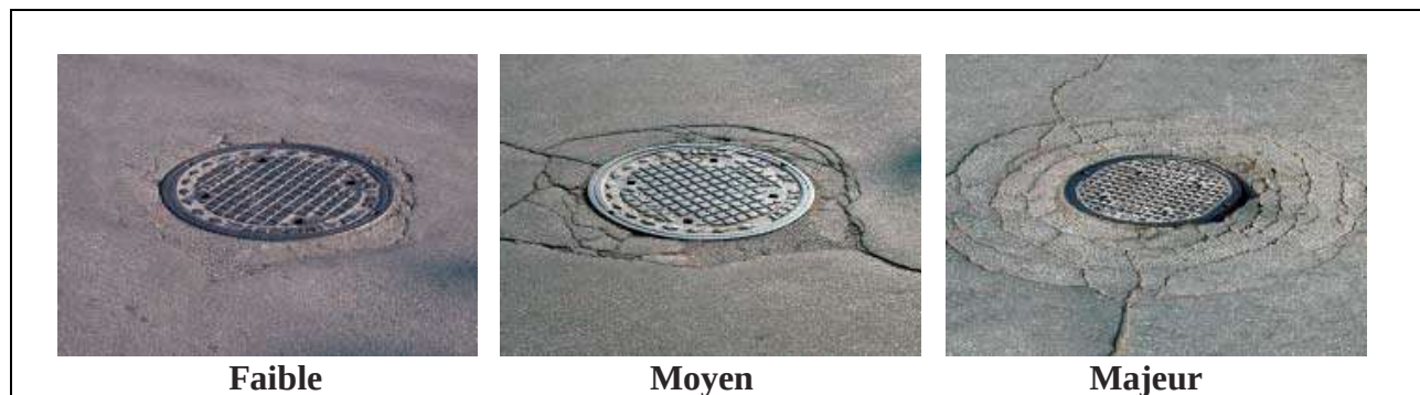
Figure I.32 : Fissuration autour des regards et des puisards (d'après AIMQ 2002)
