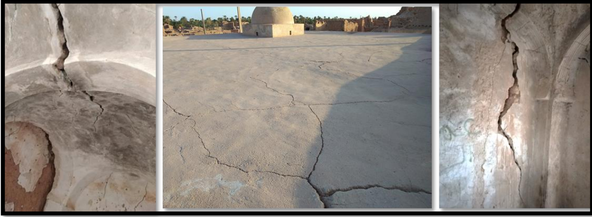
صورة رقم 67: صور للشروخ بقصر تمرنة القديمة
