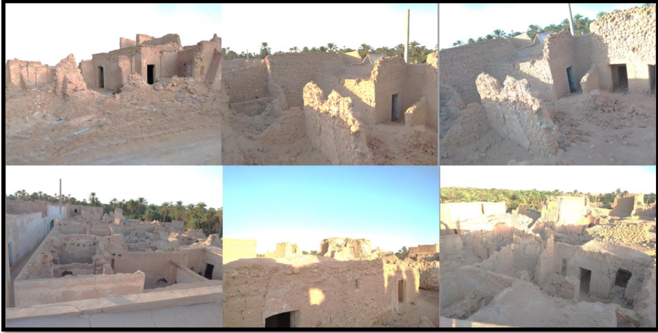
صورة رقم 71: صور للانهيارات و الهدم بقصر تمرنة القديمة
