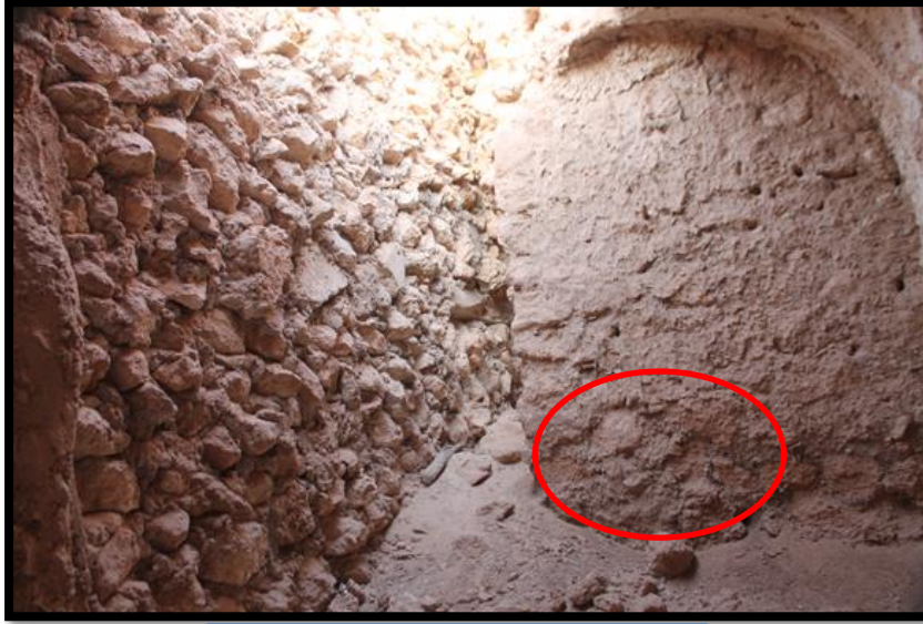
صورة رقم 68: صورة لتآكل مواد البناء بقصر تمرنة القديمة
