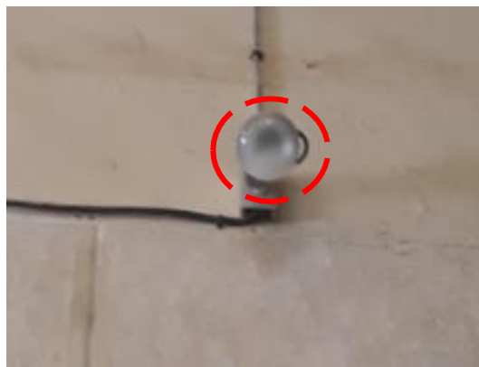
Fig. III.59 : Spot réflecteur utilisée pour l'éclairage. Source : Auteur
