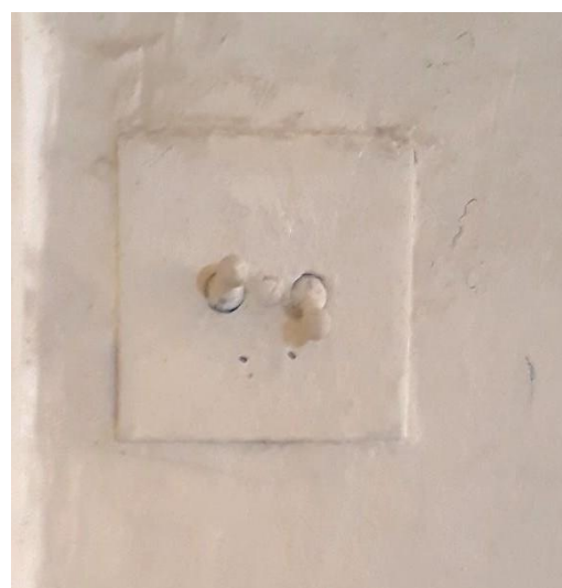
Fig. III.56 : Ancien interrupteur. Source : Auteur
