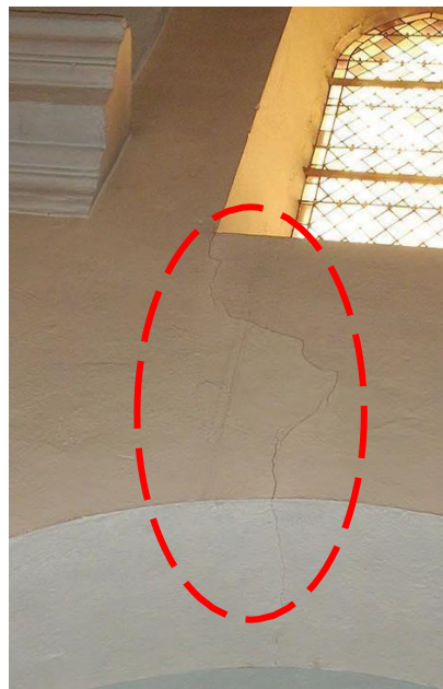
Fig. I. 30 : Fissuration due à la
