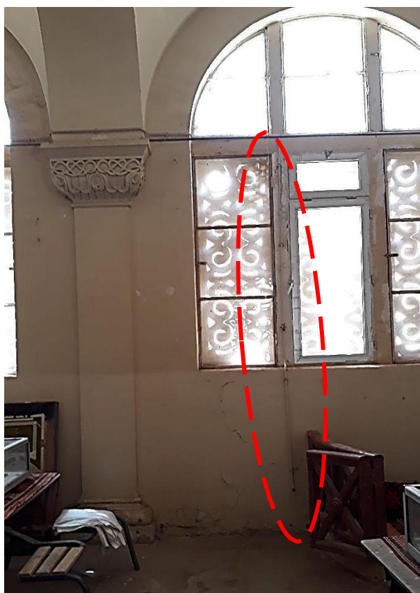
Fig. III.61 : Conduite de Gaz non adépte. Source : Auteur
