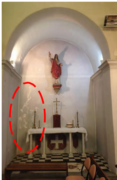
Fig. I. 29: Dégradation des enduits.
