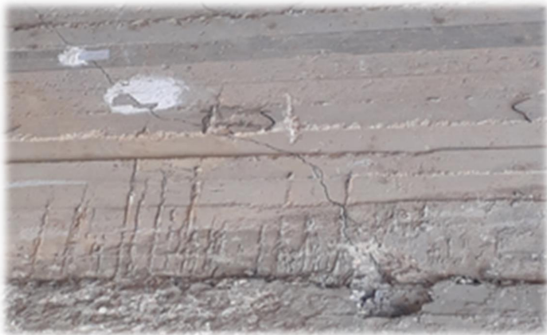
Figure III-7 : Fissures inclinées au niveau du voile de soubassement en gros béton
