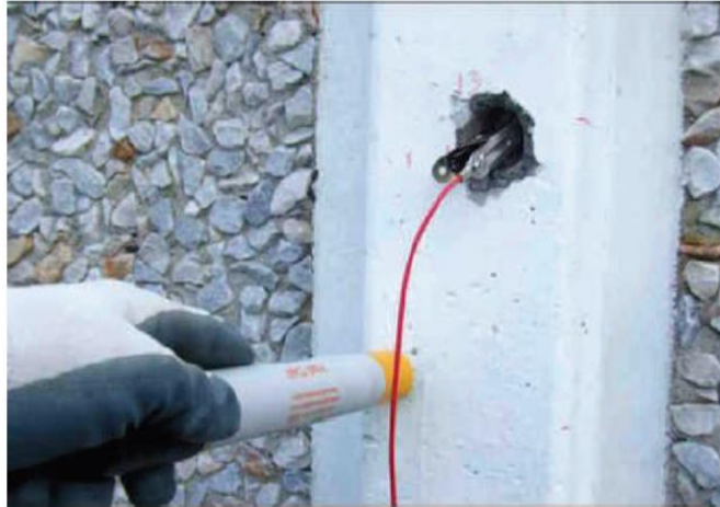
Figure II-14 : Mesure du potentiel de corrosion
