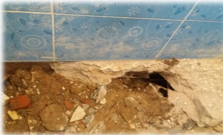
Figure III-11 : Présence de l'humidité à proximité des regards endommagés
