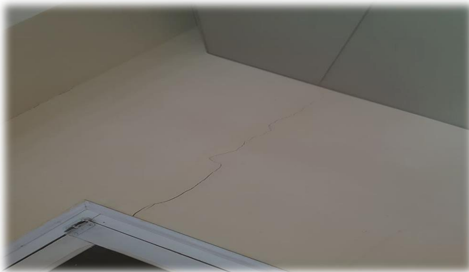
Figure III-8 : Fissures au niveau cloisons au droit des ouvertures
