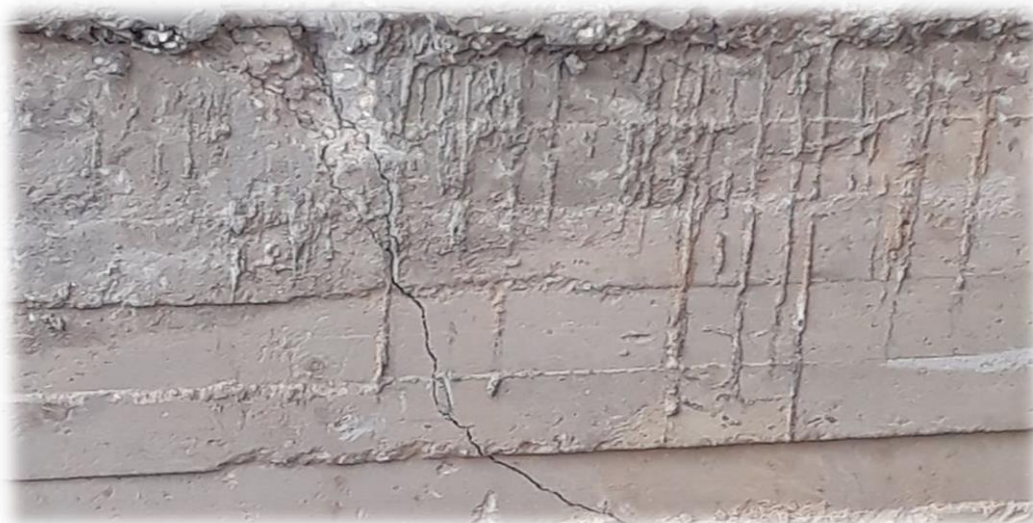
Figure III-9 : Fissures inclinées au niveau des longrines (au milieu)
