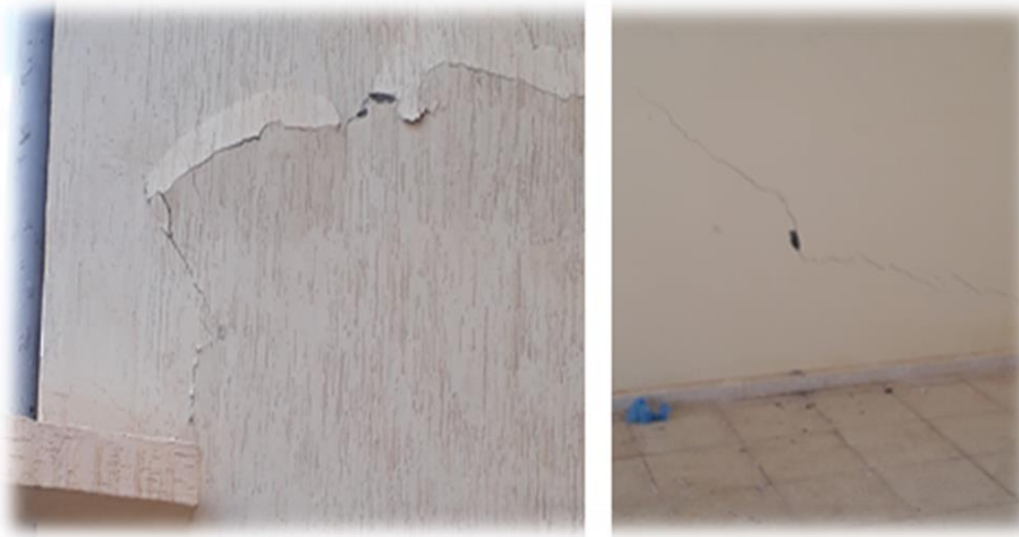
Figure III-4 : Fissures inclinées des murs extérieurs et intérieurs
