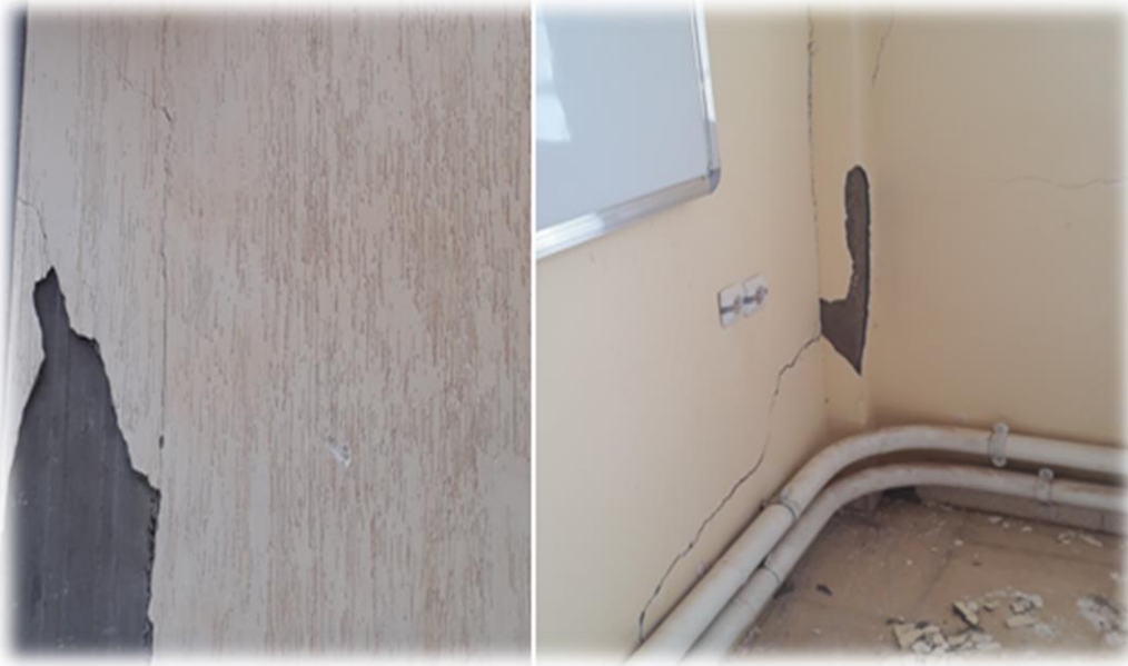
Figure III-6 : Endommagement des crépis des murs
