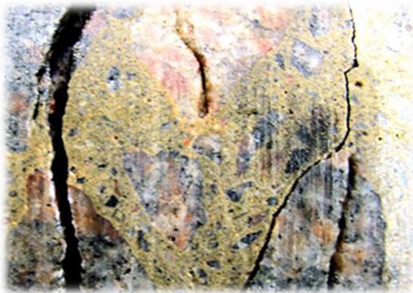
Figure I-9: Alcali-réaction du béton
