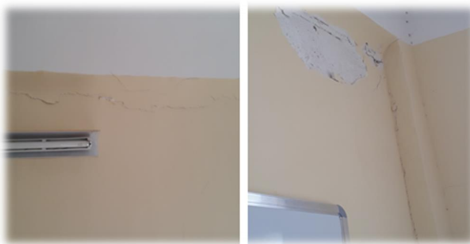
Figure III-5 : Dégradation de la peinture et fissure d'interaction (mur –structure)
