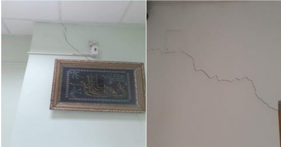
Figure III-23 : Fissures inclinées à intérieur de l'ouvrage
