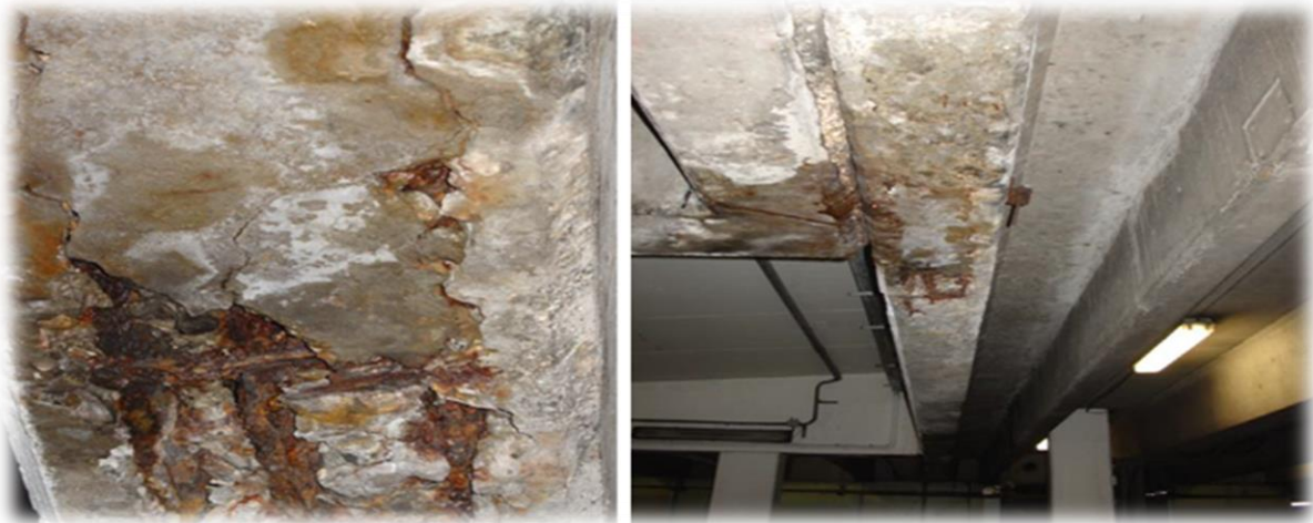
Figure I- : Phénomène de Corrosion (ouvrage parking)
