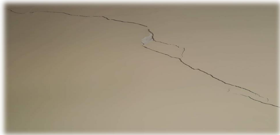
Figure I-18 : Fissure oblique au niveau d'un mur
