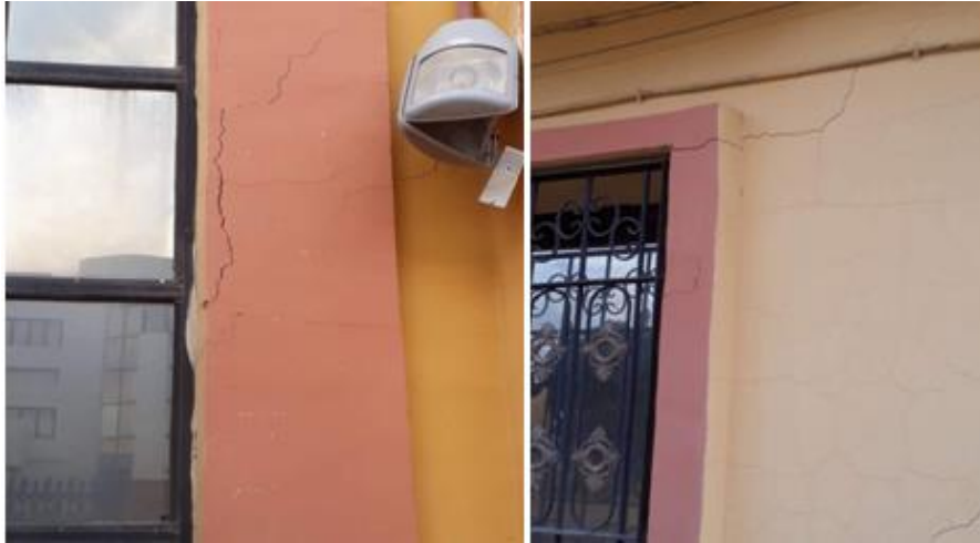
Figure III-20 : Fissures au niveau des cloisons
