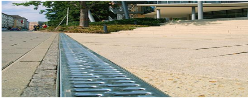
Figure 276 : La gestion des eaux pluviales sur les voiries. Source : Etude sur la gestion de l'eau dans les projets présentés à l'appel à projets Eco Quartiers 200
