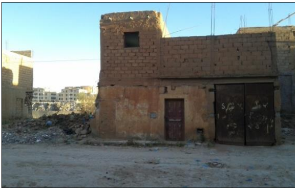
Figure 185 : habita mauvaise état, source : capture par les auteures
