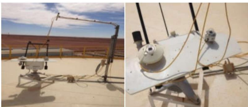
Figure III. 24 : La station météorologique de la centrale hybride [16]
