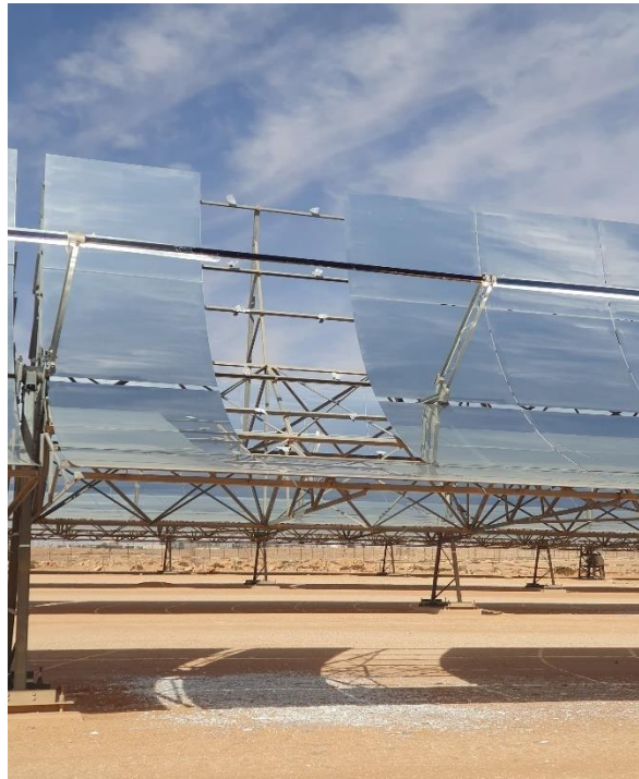
Figure IV. 20 : L'État de cassure des miroirs
