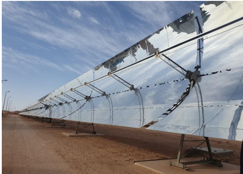
Figure IV. 16 : Photo réelle du champ solaire SPP1 [22]
