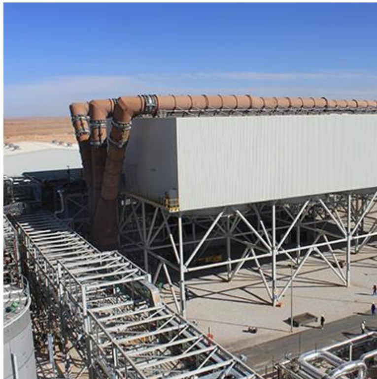
Figure III. 13 : Aérocondenseurs de la centrale de Hassi [15]
