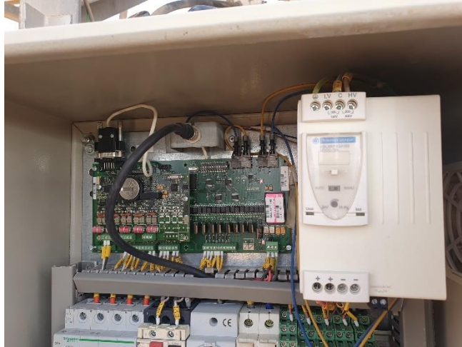
Figure IV. 18 : Partie Instrumentation dans l'armoire (Contrôle de communication). [22]
