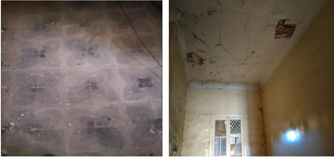
الشكل 207: حالة الجدران الداخلية للغرف و الأرضية. المصدر: الطالب.
