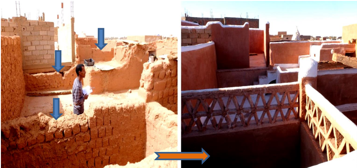
الشكل 124: لسطح الجدران قبل و بعد التأهيل. المصدر: Guide_rehabilitation_Timimoun.pdf
