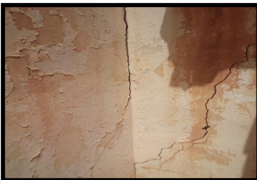
الشكل 77: صورة شروخات في الجدار المصدر: مكتب دراسات
