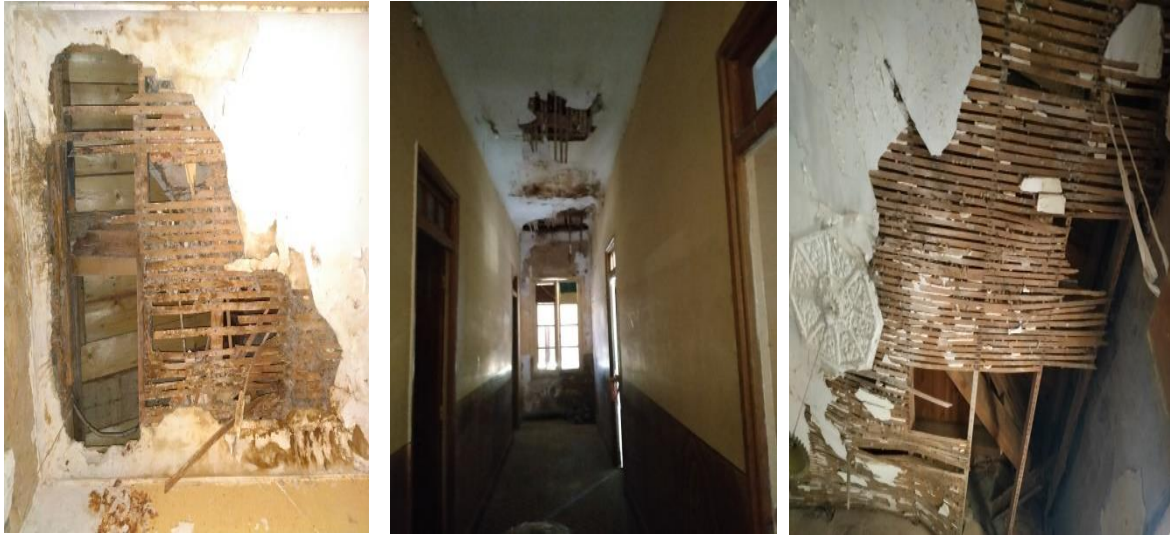
الشكل 209: صور لحالة السقف قبل إعادة التأهيل. المصدر: مقياس أمراض البناء سنة ثانية ماستر.
