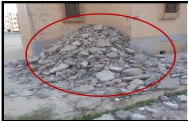
Photo 02 : mauvais gestion de déchets de chantiers. Source : pris par l'auteur
