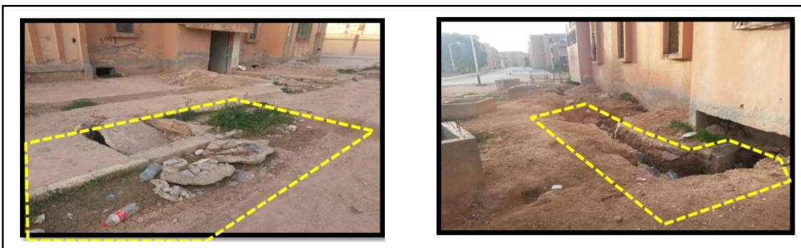
Photo 51.52 : Mauvaise d'états des réseaux d'assainissement. Source : pris par les auteurs
