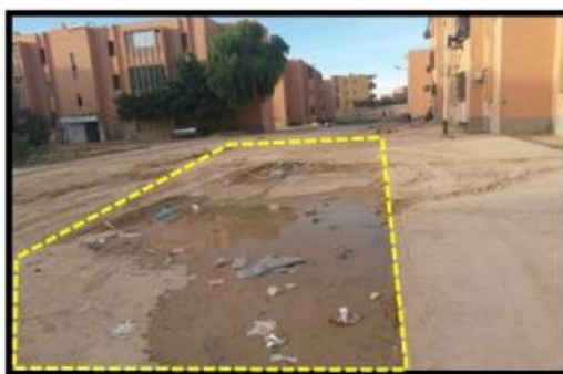
Photo 49 : Absence de gestion des eaux pluviales Source : pris par les auteurs
