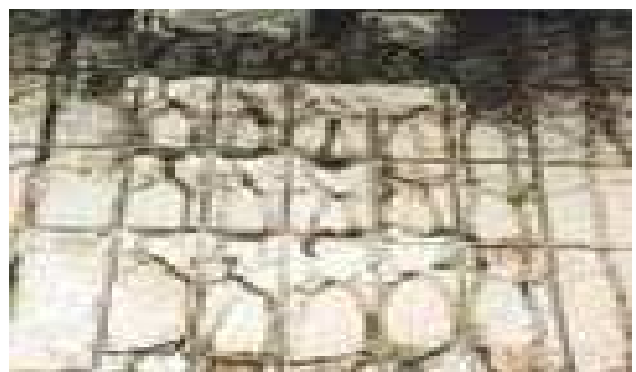
Figure I. 10: Dégradation causée par incendie.
