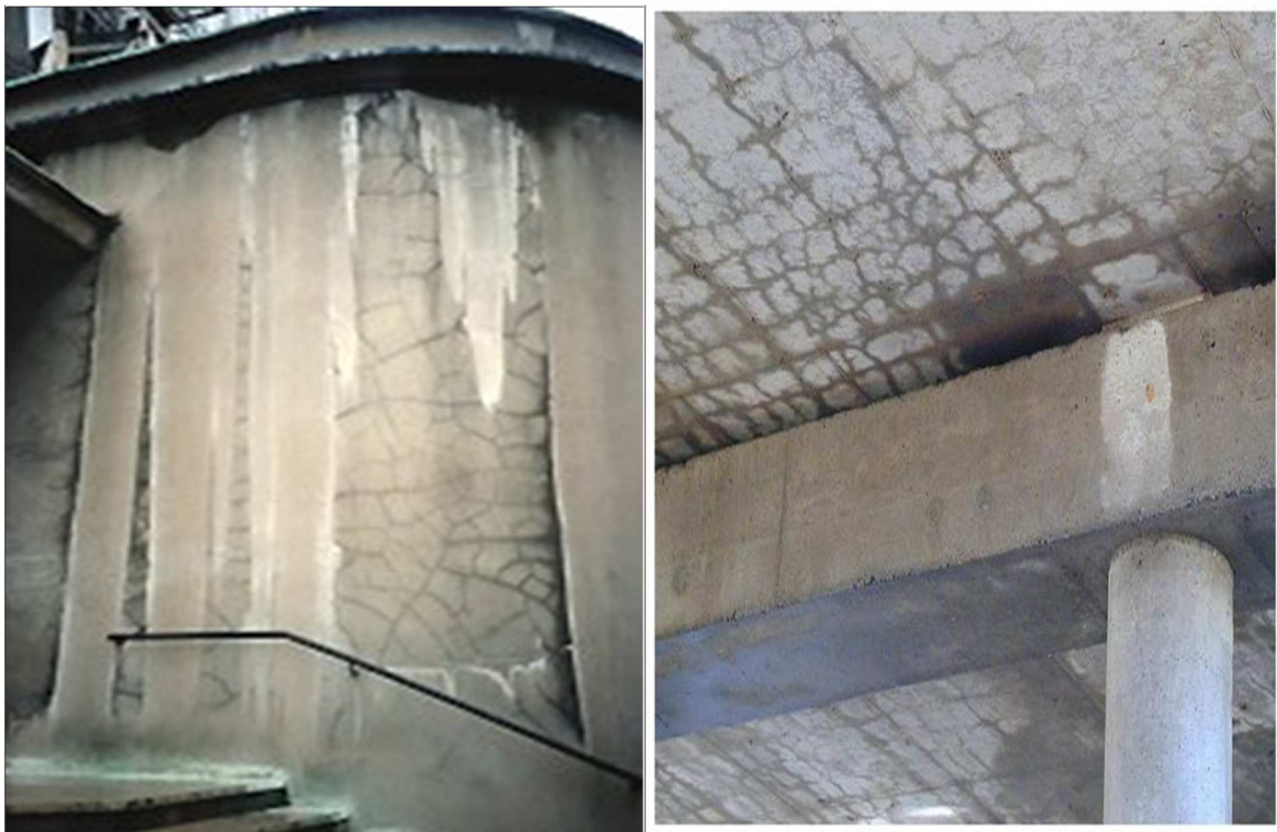
Figure I. 5: Dégradation du béton par des sulfates
