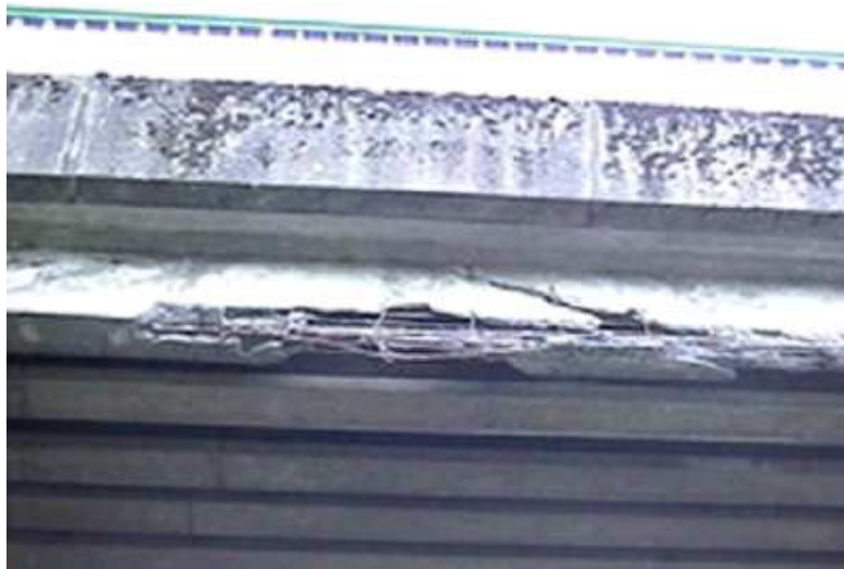
Figure I. 8: Dégradation du béton par choc
