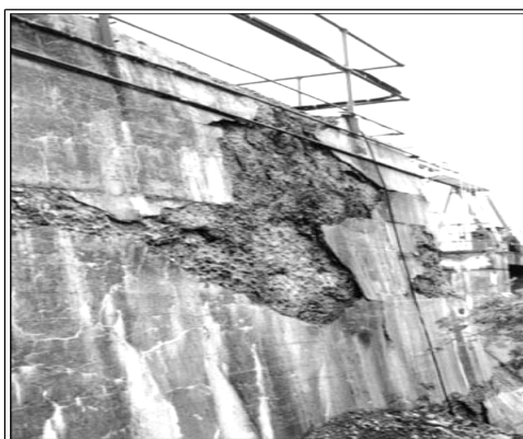
Figure I. 11:Dommages causé par le gel-dégel
