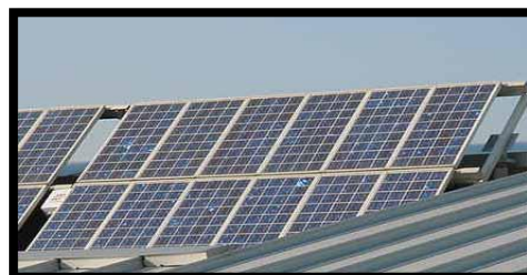
Photo 26 : Les panneaux photovoltaïques
