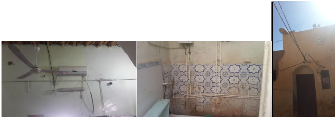
Photo II .71 : installation CES des la mosquée Source : (Laroui I et Chaoui L, 2017)
