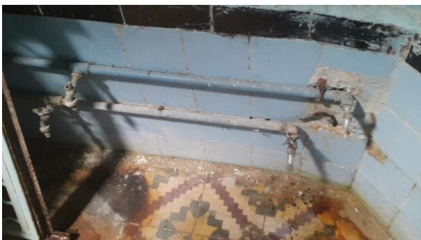
photo II.77 : état des robinet existants
