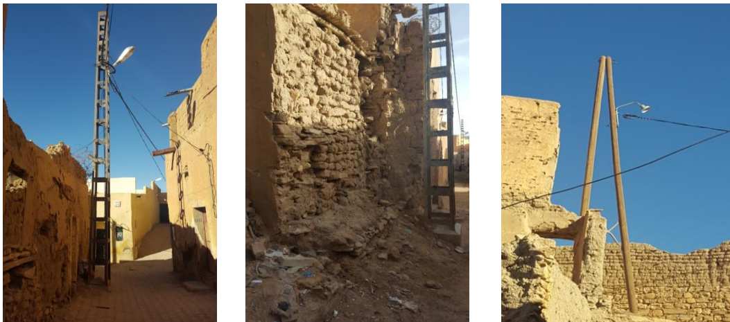
Photo II.32: installation électrique extérieur du ksar Source : (Laroui I et Chaoui L, 2017)
