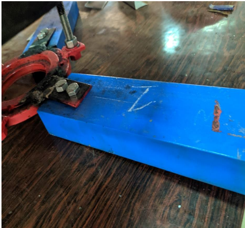
Figure III. 13. les pieds des vannes
