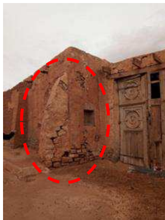
La dégradation du contrefort
