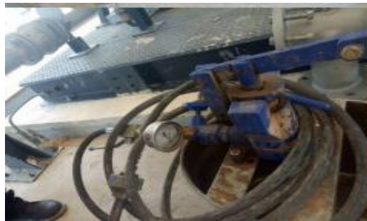
Figure II.12 Quelques équipements utilisés dans le test hydrostatique.
