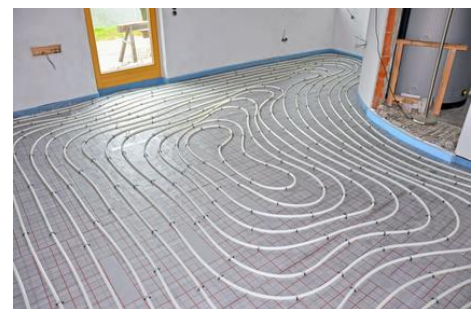
Figure 150 : Chauffage au sol
