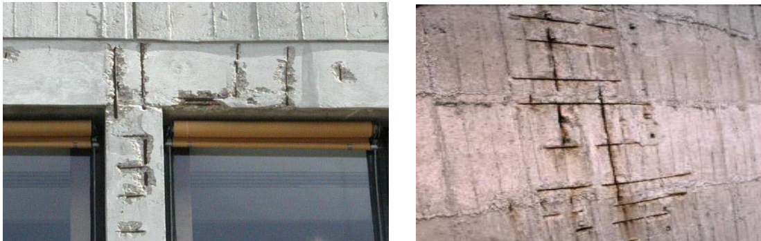
Figure I.6 Corrosion des armatures du béton
