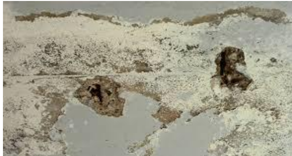
Figure I .5 . Effet de contraintes thermiques
