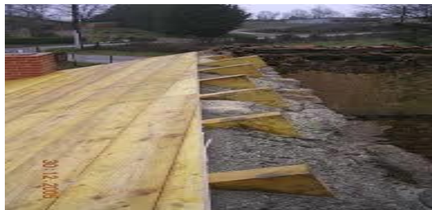
Figure I.4. Défaut de coffrage
