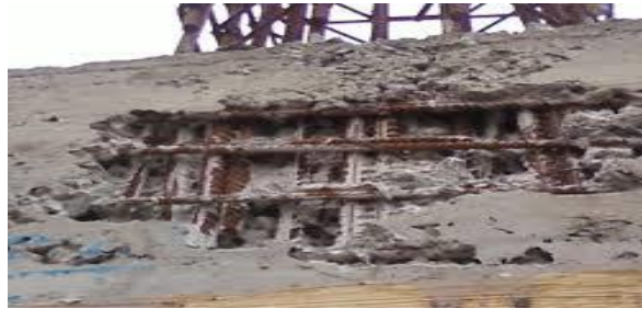
Figure I.3. Ségrégation du béton
