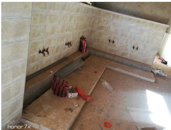
Photo 56: la salle d'eau l'intérieur de la mosquée.
