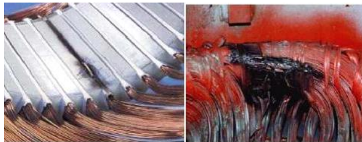
Figure (1.7) : Défaut d'un court circuit statorique
