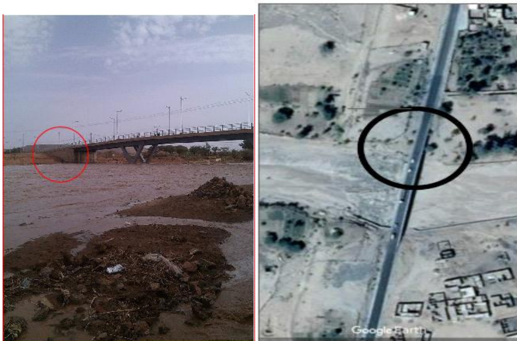
Figure .I.16: zone faible du pont
