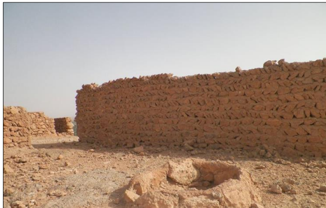
Figure 16 صورة أجزاء من المساكن منهارة في القصر المصدر : الباحث بتاريخ 2022-02-19
