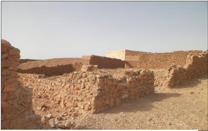
Figure 14 صورة أجزاء من المساكن منهارة في القصر المصدر : الباحث بتاريخ 2022-02-19
