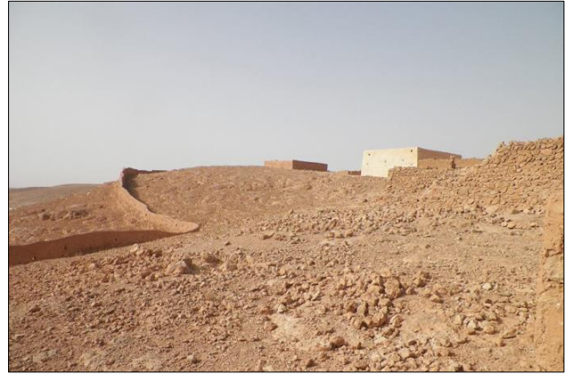
Figure 13 صورة أجزاء من المساكن منهارة في القصر المصدر : الباحث بتاريخ 2022-02-19
