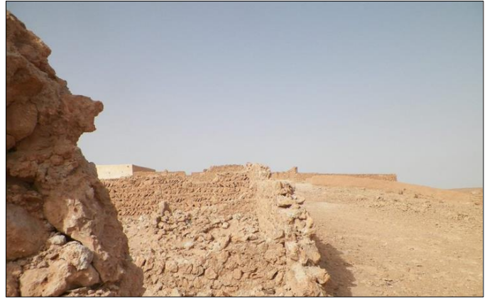
Figure 15 صورة أجزاء من المساكن منهارة في القصر المصدر : الباحث بتاريخ 2022-02-19
