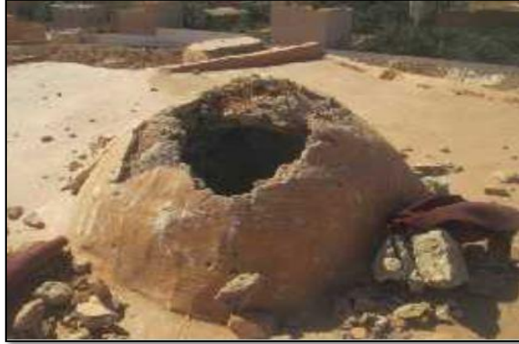
صورة 93 انهيار بعض اجزاء القبة على مستوى السطح (المصدر الطالب).
