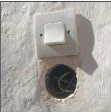
صورة 64 تلف الأجهزة الكهربائية (الطالب)
