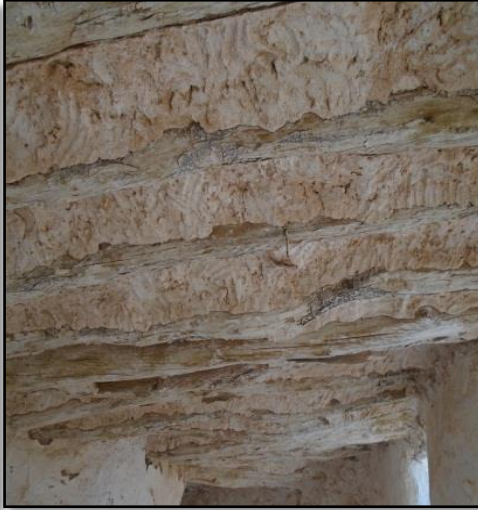
صورة 47 تدهور وتقوس سقف الممر (الطالب)
