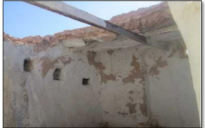
صورة 57 انهيار شبه كلي لسقف المصلى استعمال العوارض الحديدية (الطالب)
