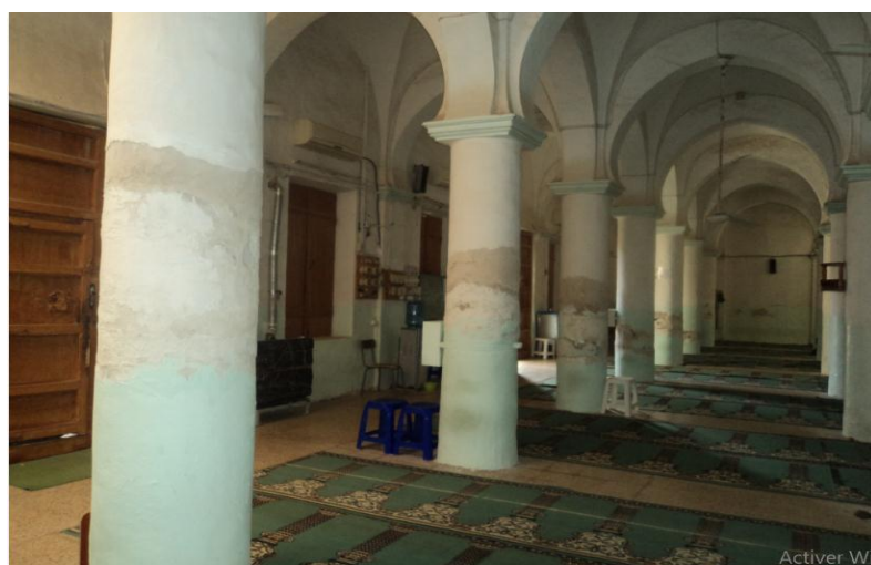
صورة 30 : تظهر تأثير الرطوبة على الاعمدة داخل قاعة الصلاة
