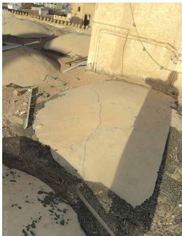
صورة 24 : تظهر التشققات على القباب بالسقف الخارجي و نفوذ مياه الامطار منها للداخل
