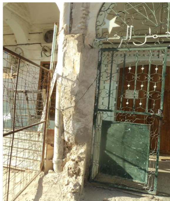
صورة 08 : تظهر تأثير الرطوبة على الجدران
