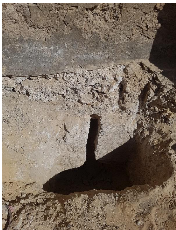
صورة 14 : تظهر تأثير الرطوبة على قواعد الجدران الخارجية
