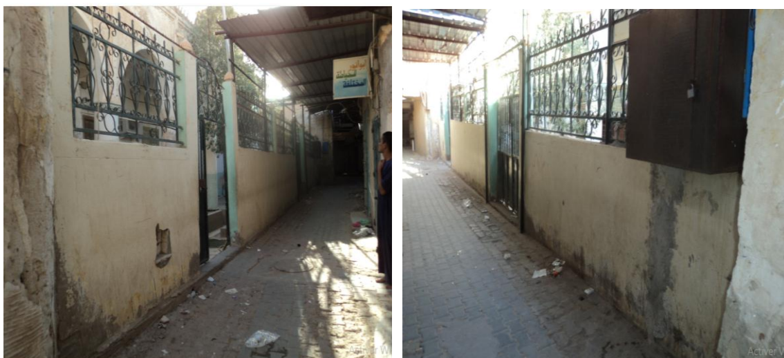
صورة 17 : تظهر تأثير الرطوبة على قواعد الجدران الخارجية للسور
