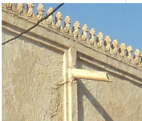
صورة 06 : تظهر تلف ميزاب تصريف مياه الامطار
