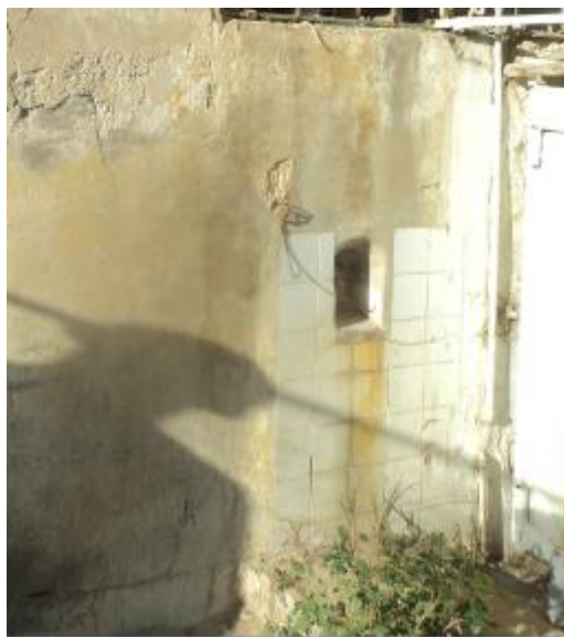
صورة 07 : تظهر تأثير الرطوبة على الجدران
