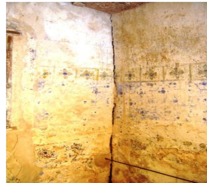
صورة 52: مناظر تشققات المبنى.
