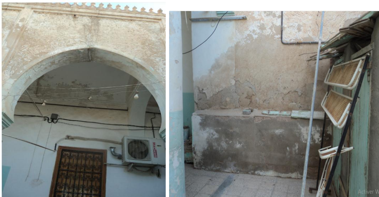
صورة 21 : تظهر تأثير الرطوبة على الجدران و الاقواس جهة المدخل الشمالي
