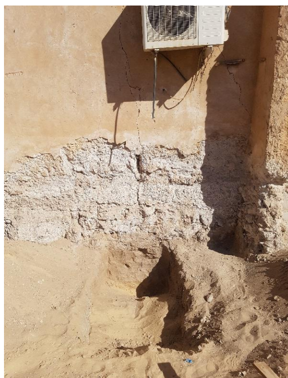
صورة 13 : تظهر تأثير الرطوبة على الجدار الخارجي
