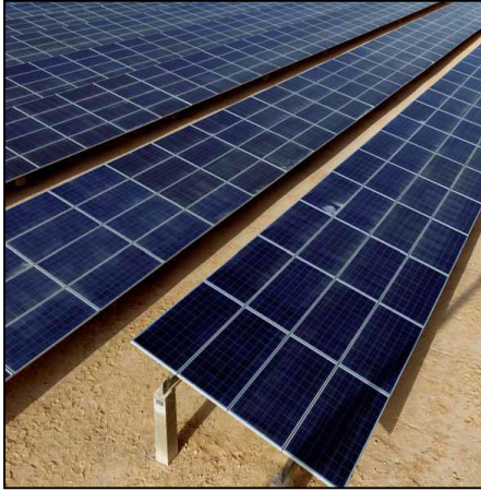
Fig1. Les panneaux solaires
