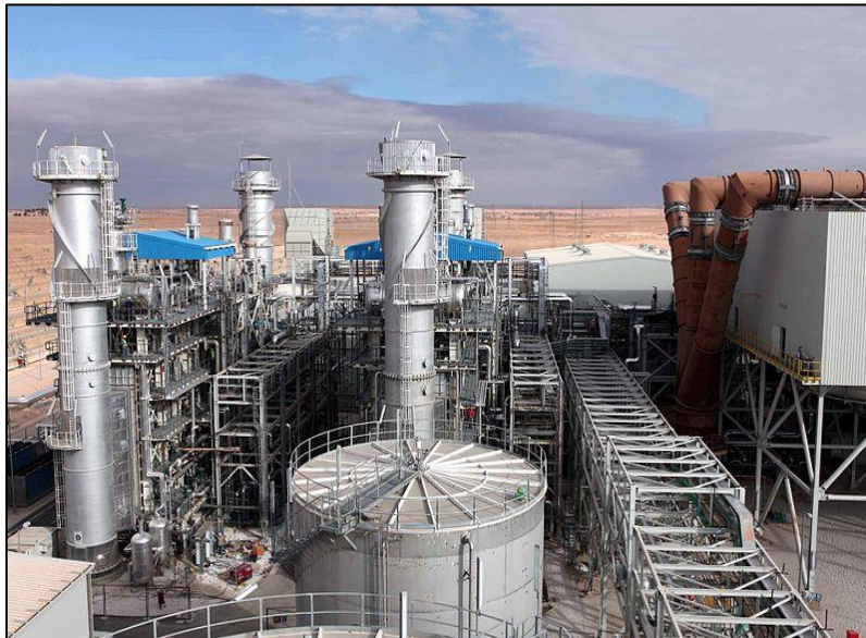
Fig1. Centrale électrique de Hassi-R'mel
