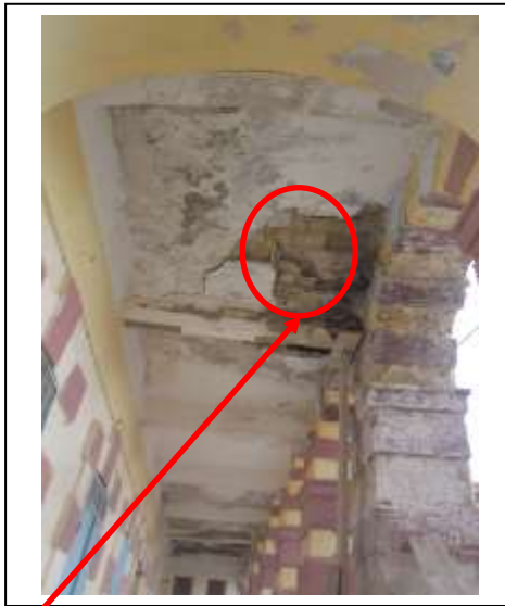
Détérioration des voûtes (cause: humidité, présence d'un sanitaire au dessus et perméabilité de la terrasse)
