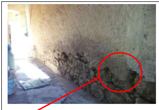
Altération des soubassements (cause: remontée capillaire)
