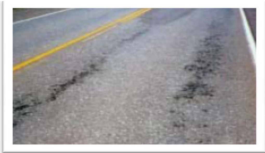
Figure II.14 : Désenrobage et arrachement [16] .
