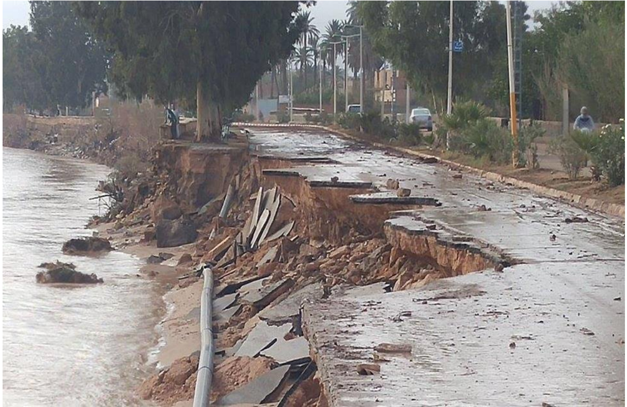
Figure II.7 : Dégât Oued M'zi 2016[33].
