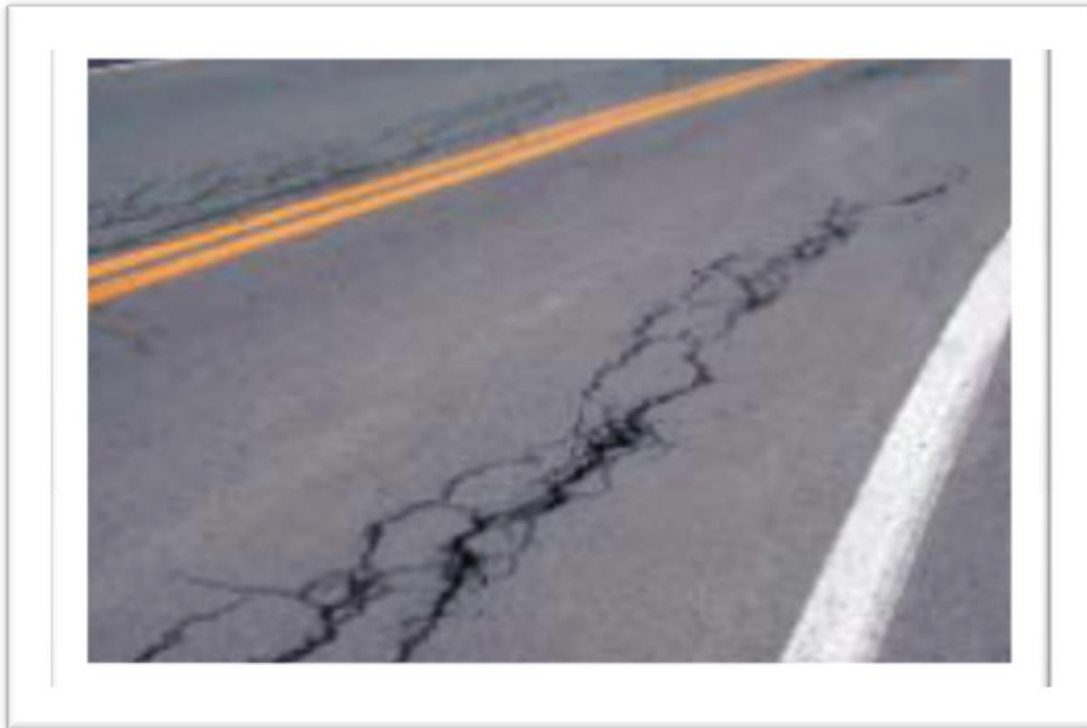
Figure II.12 : Fissure en piste de roues [16] .
