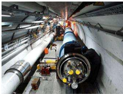
Figure I. 1. Section souterraine du LHC [01]
