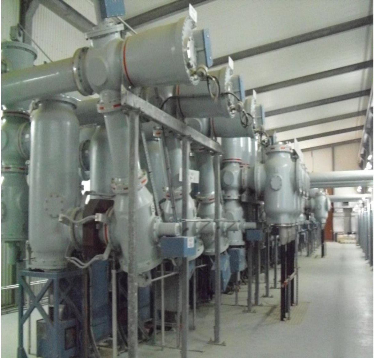
Fig 1.1 L'intérieur du poste blindé 220/60 kV de Tilghimt (Hassi R'mel)
