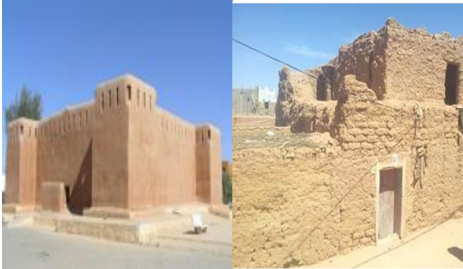
Figure I.3. Les désordres du mur en brique de terre (Toub) à Tamanrasset
