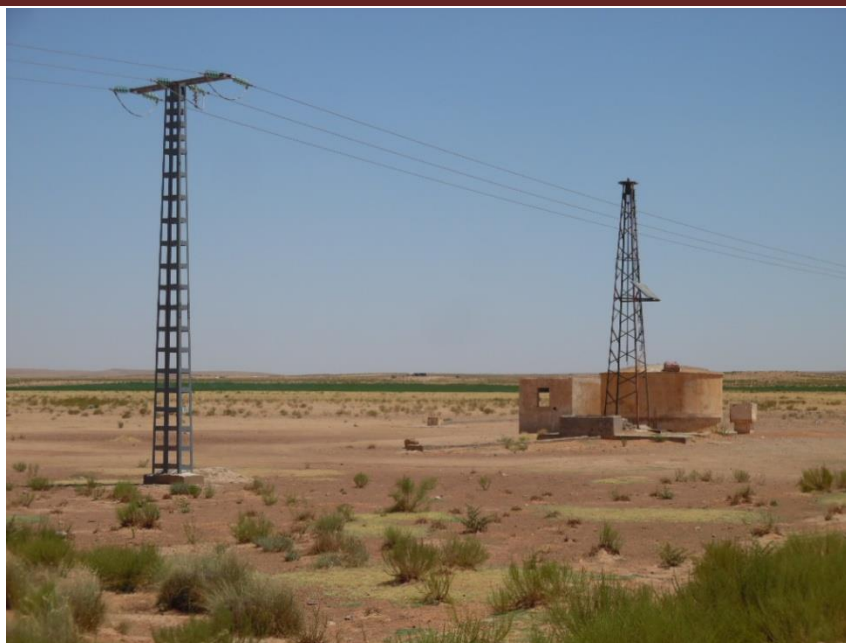
Photo 5 : Presence de la ligne eletrique
