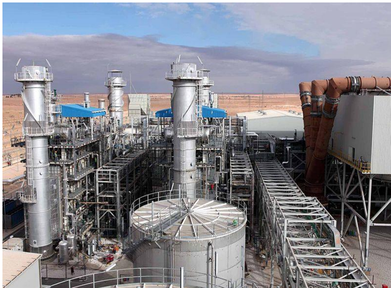
Fig1. Centrale électrique de Hassi-R'mel
