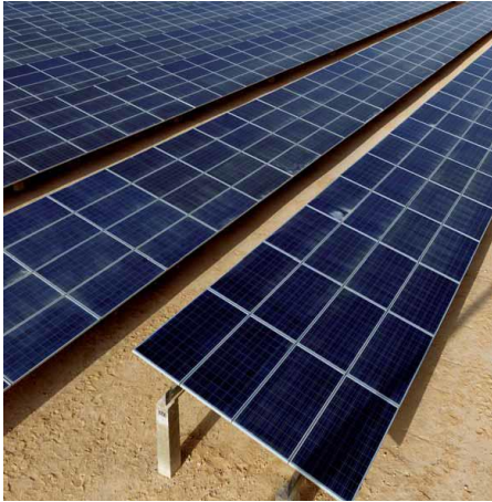
Fig1. Les panneaux solaires
