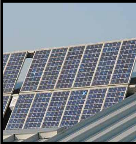
fig.12:les panneaux photovoltaïque dans le lycée- source: www.prog-ecologis.com
