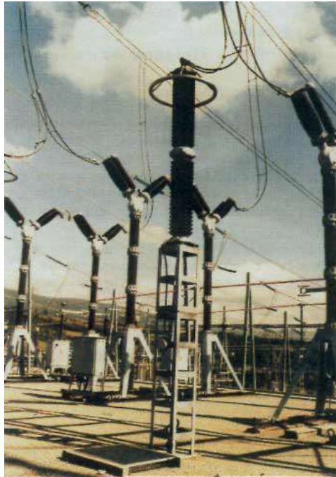
Le parafoudre, au premier plan, est surmonté d'un anneau de répartition de champ
