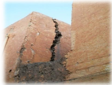
Figure 11 : dégradation du bâti Source : les étudiants
