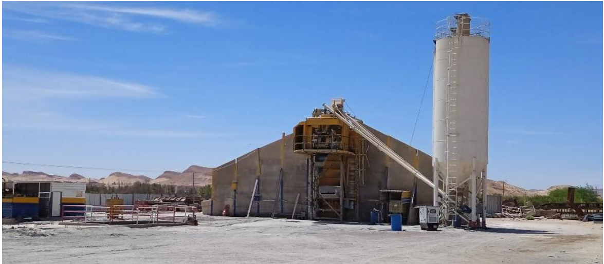
Figure IV. 5 - Centrale à béton [26]
