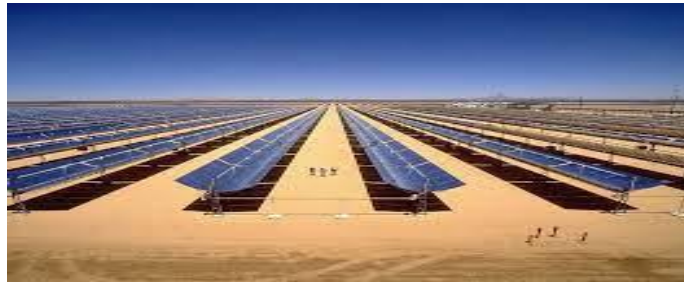
Figure I. 4 : panneaux solaire thermodynamique
