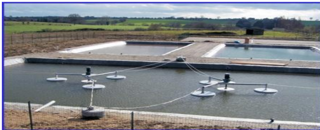
Figure II.9: Photo de bassins de lagunage aéré [48].
