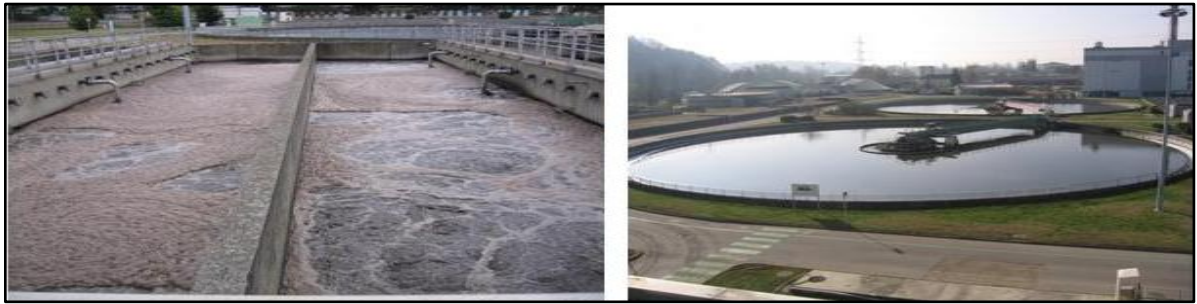
Figure II.6: Bassin d'aération (à gauche) et les décanteurs secondaires (à droite)[38]
