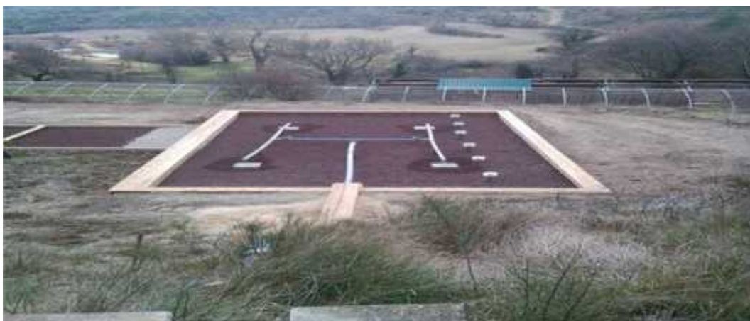
Figure. 30 : les canalisations d'alimentation
