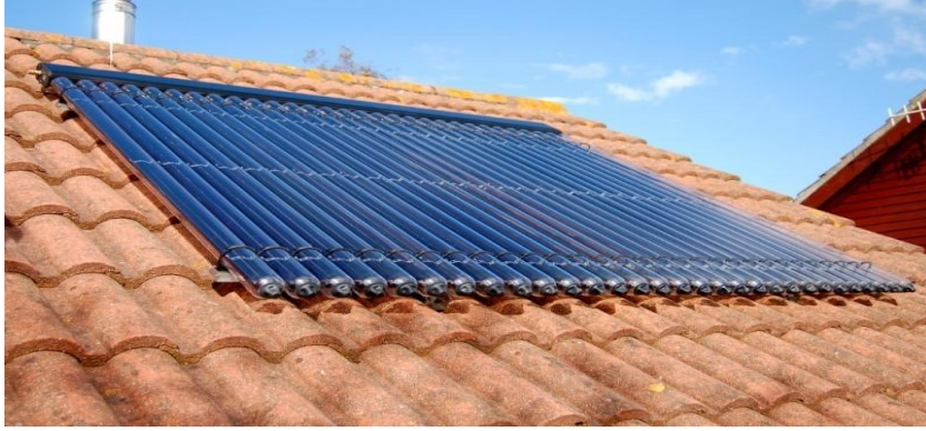
الصورة رقم 44: توضح المسطح التجميعي للأنايبب الزجاجية
