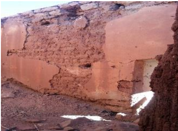
Fig. III.A.30. mur en cour de détériorations
