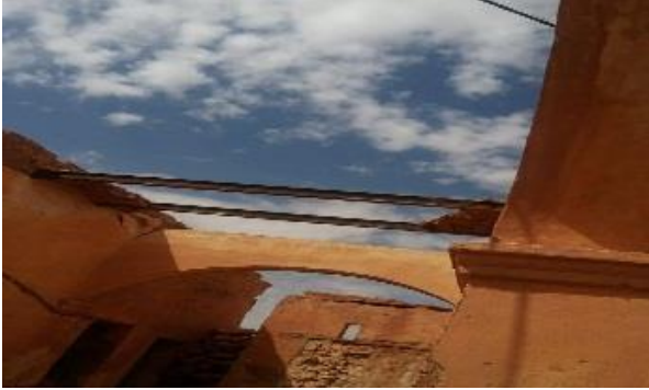
Fig. III.A.28. effondrement de plancher
